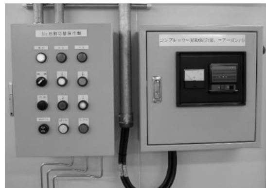
N 2 自動切換操作盤、コンプレッサー制御盤
