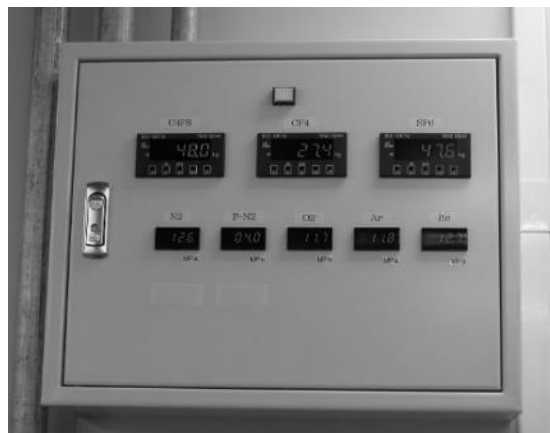
ガス残量表示盤
