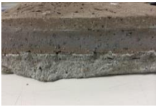
b) 剥離剥落部
