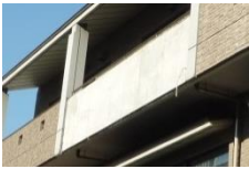
a) 剥離剥落部
