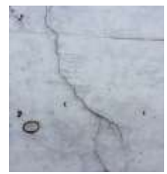
b) 劣化箇所写真
