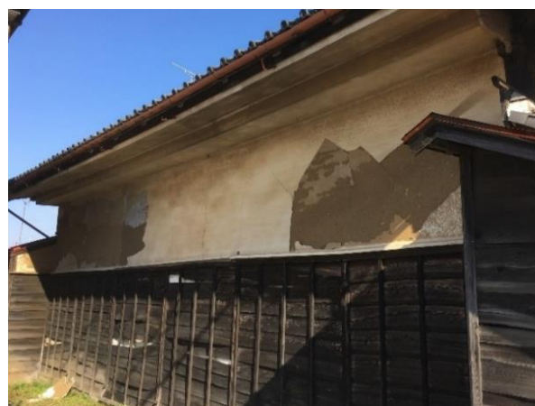
写真 1 漆喰剥離劣化
