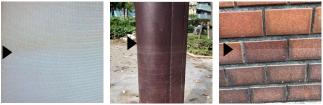
写真2 水害発生浸水高跡
