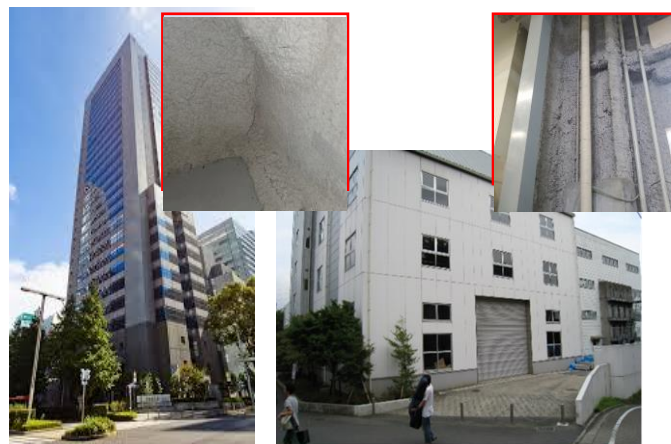
a) 施設 A の耐火被覆状態
