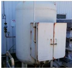
b) ボイラー(ユーティリティ)
