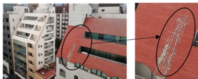
a) 仕上げ材にタイルを用いた斜壁の劣化事例
