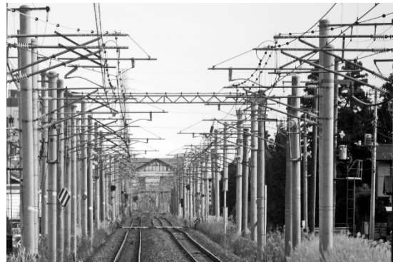
画面奥が交流(藤代駅)、手前が直流(取手駅側)
