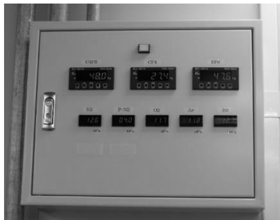
ガス残量表示盤
