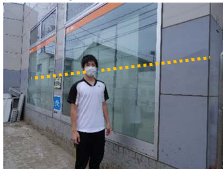
図3:建物に残る浸水の跡
