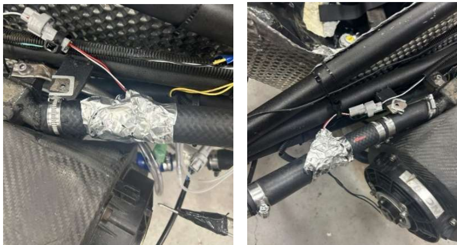
Fig.1 両ラジエーターの水温センサー
